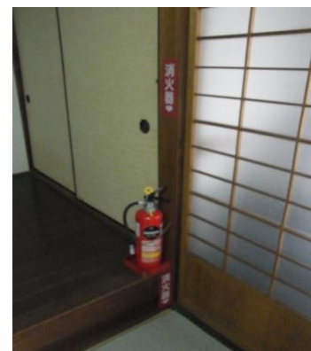
助産師会館内の消火器は玄関とステージ横に設置しています。
